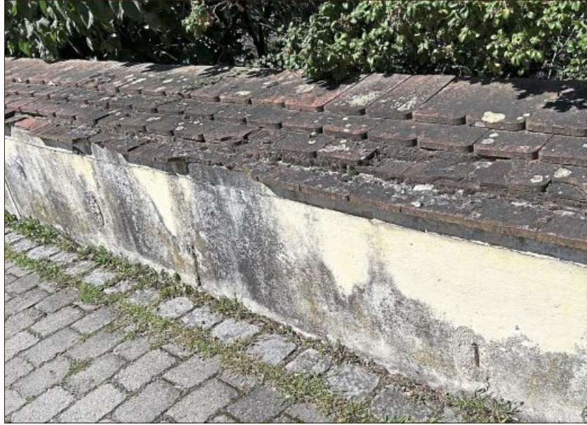
Die Abdeckung der Friedhofsmauer zeigt deutliche Schäden auf und ist...
