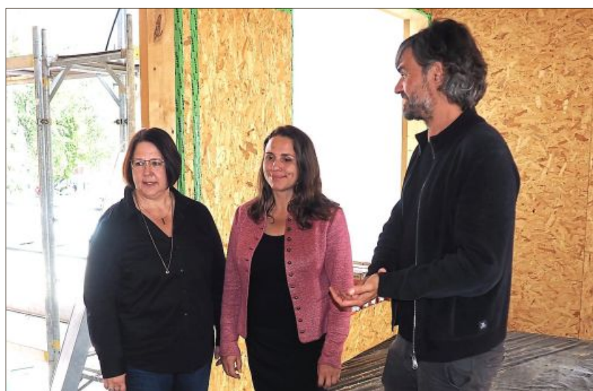
Architekt Sebastian Hrycyk informierte die Einrichtungsleiterin Sabine Schuder und Bürgermeisterin Irgard Eberl über den Bautenstand.
