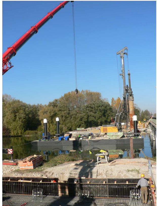
Die Großbohrpfähle für die Pfeiler wurden von einem schwimmenden Ponton aus hergestellt.
