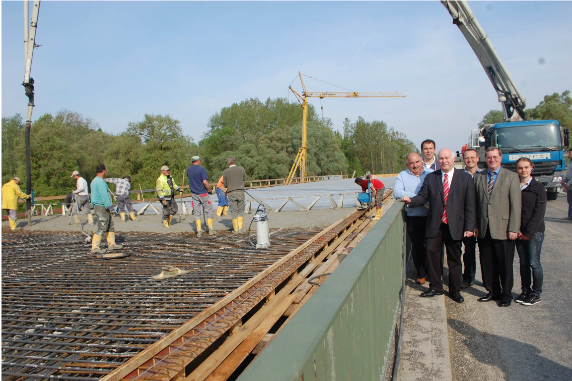
Auch beim Betonieren der Ortbetonplatte im April 2011 stattete die Bauherrnschaft der Baustelle einen Besuch ab, um sich vom Fortschritt der Arbeiten zu überzeugen.
