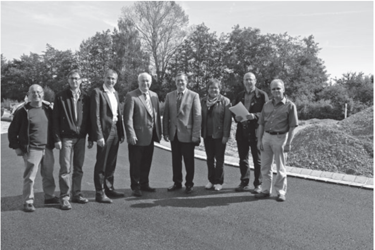
Besichtigung des Kreisverkehrs Mammingerschwaigen während der Bauphase. v.l.n.r.: Walter Wimmer, Gerhard Lehl, 2. Bgm. Werner Bumeder, Landrat Heinrich Trapp, 1. Bürgermeister und stv. Landrat Georg Eberl, Margit Ransberger, Ludwig Meindl, Richard Wagner
